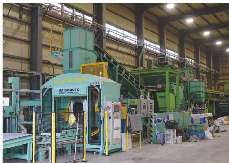
セメント原燃料化の設備 自動的に圧縮し、ラップを巻いた状態にする
